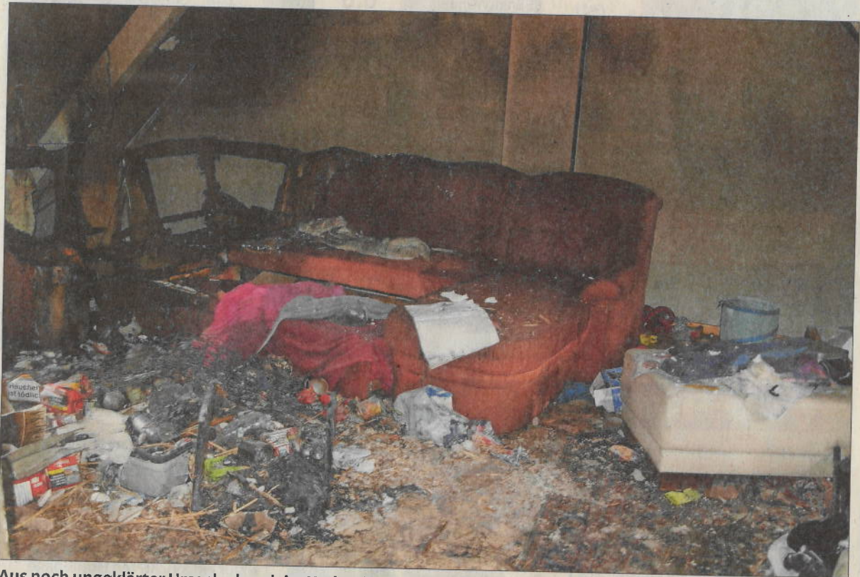
Aus noch ungeklärter Ursache brach im Wohnzimmer einer Dachgeschosswohnung in der Horebstraße 38 am Samstagnachmittag ein Feuer aus. (Foto: Schröder)
