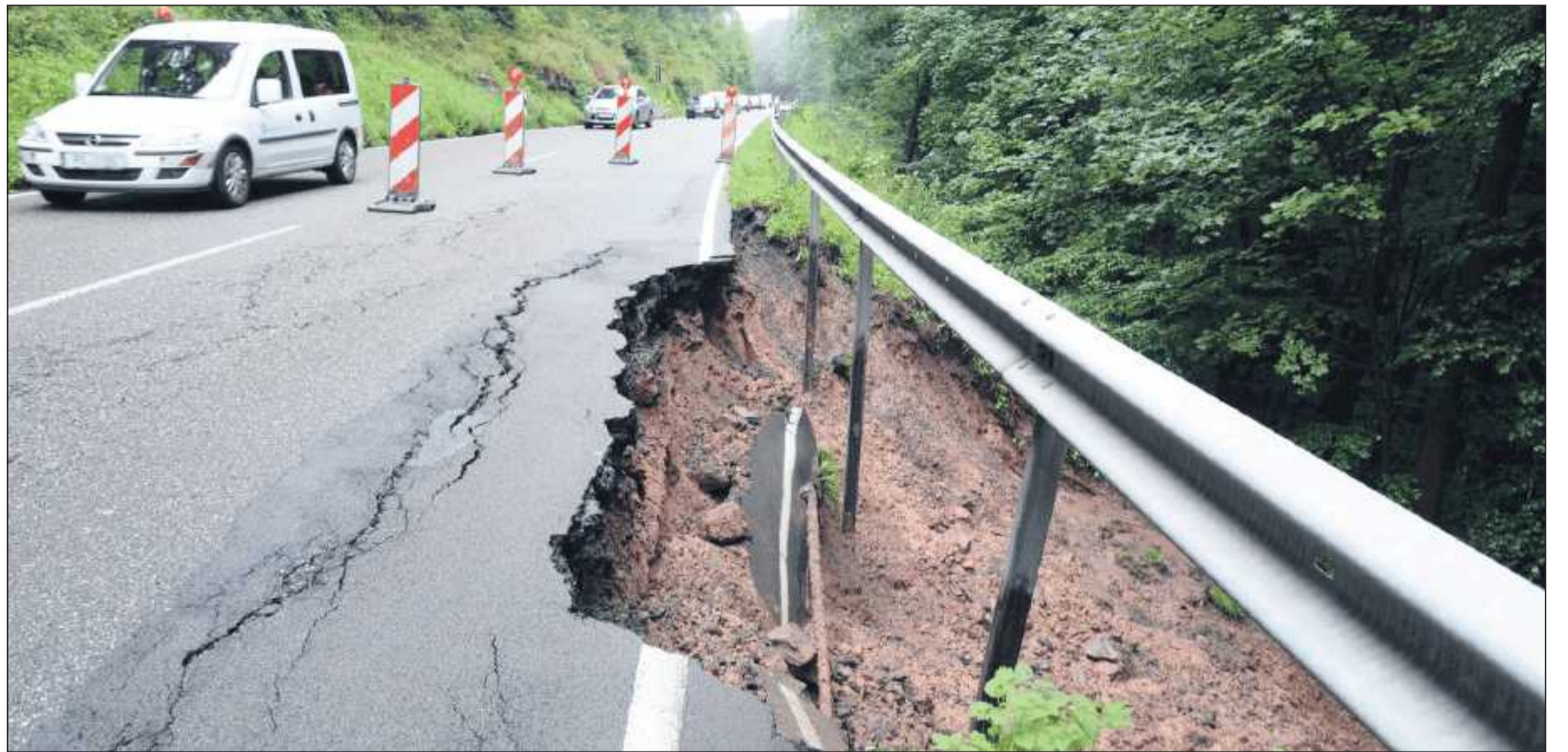
Abgerutscht und für die nächsten drei Wochen gesperrt: Die L 482 auf der Bärenhalde zwischen Pirmasens und Rodalben.
