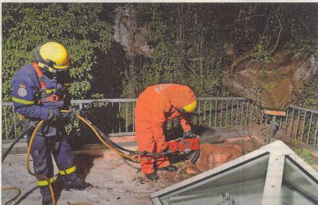
In der Hauptstraße war hinter einem Gebäude ein tonnenschwerer Felsbrocken abgestürzt. Mit der Betonkettensäge zerteilten THW-Helfer den Fels und sicherten somit das Gebäude.
